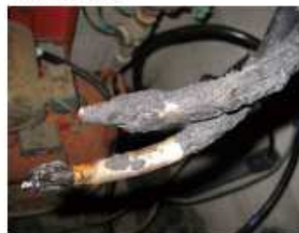
電源ケーブルの焼損
