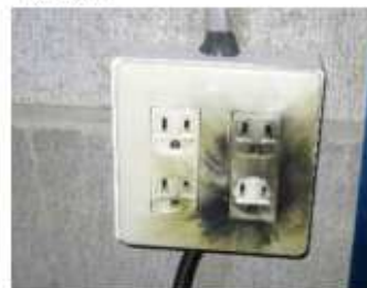
コンセントの焼損
